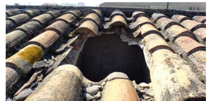
Un dels nínxols afectats pel deteriorament
