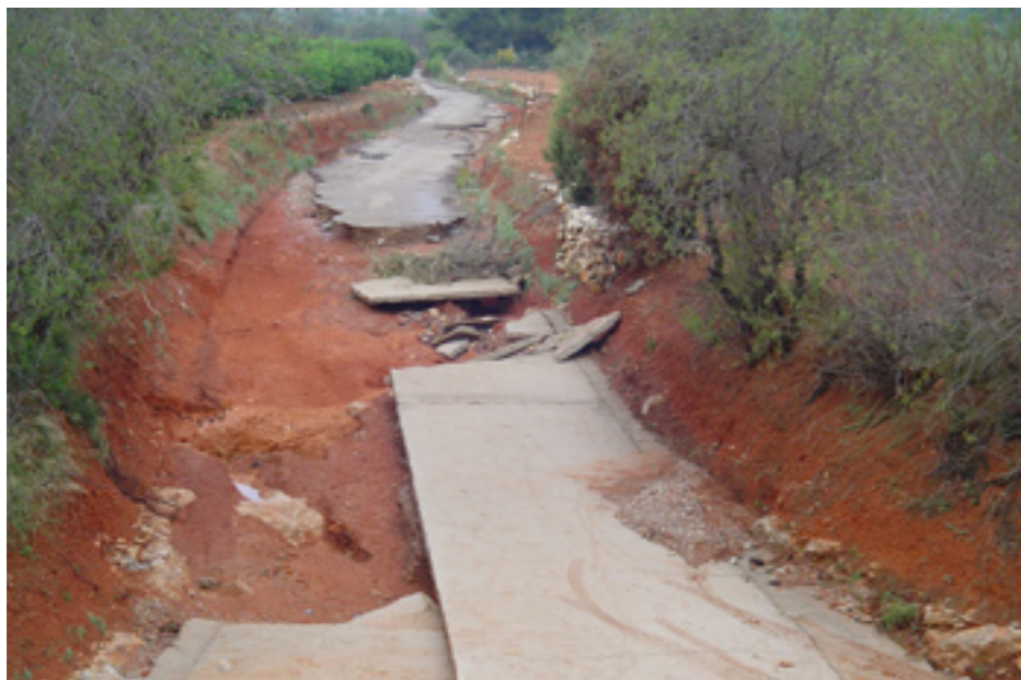
Desperfectes ocasionats en el camí de la Basseta, un dels més afectats
